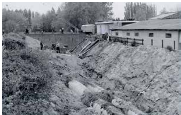
De Linie van Hooff is inmiddels voor een groot gedeelte gedempt. De foto geeft een beeld van de rioleringswerkzaamheden. (Stedelijk Museum Zutphen, foto Zeylemaker)
