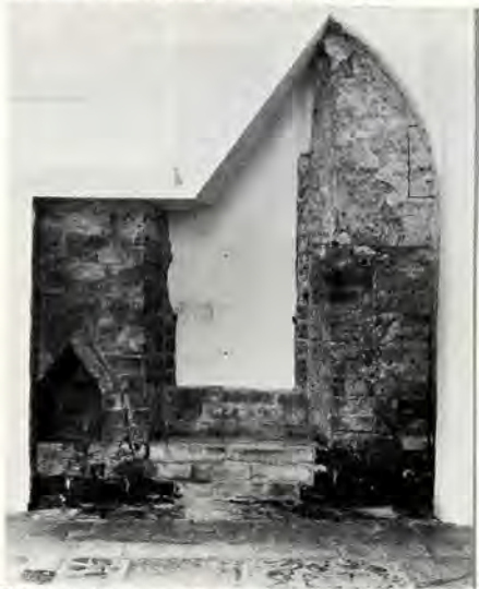
Een nu dichtgemetselde, laaggeplaatste opening in de zuidwand van het koor. Blijkens de gehengduimen kon de opening met twee blinden worden gesloten. De gaten met houten pluggen in het onderste deel van de muur maken een betimmering aannemelijk. Alles is zonder verfraaiing gelaten zoals het werd aangetroffen.
