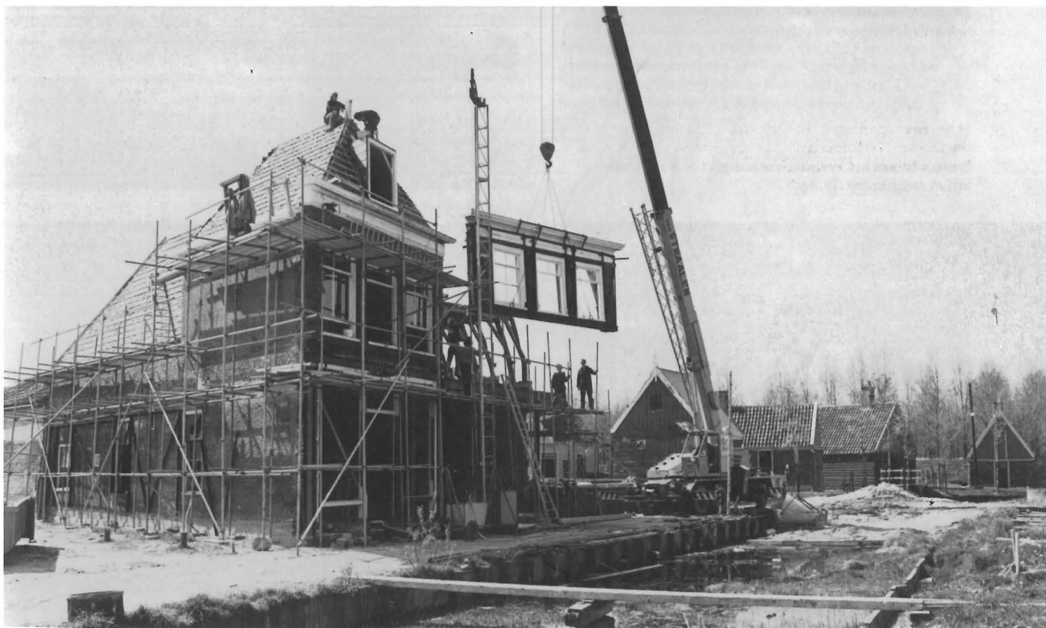
Plaatsing van het ingepakte bovenstuk van een lijstgevel van een pand uit Hoorn, dat aan de stadsgracht in het Buitenmuseum werd herbouwd, 1979.
